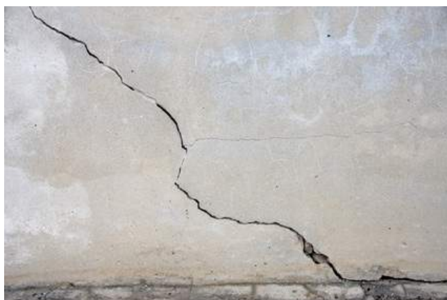
Risse im Untergrund
